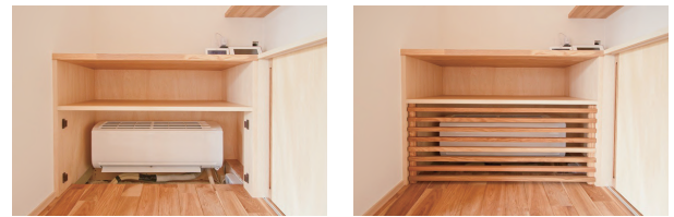
意匠性をよくした床面に設置したエアコン
